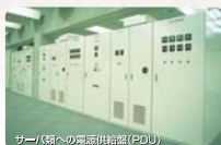
サーバ(箱への電源供給機(PDU))
